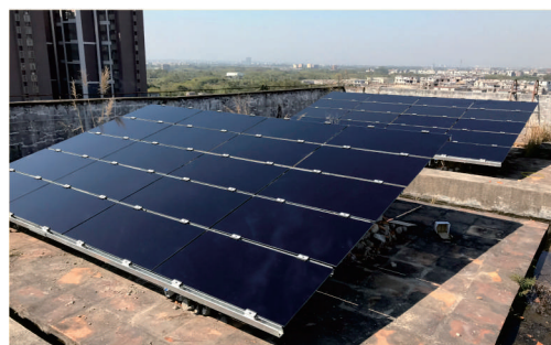
扶貧項目-揭陽南溪鎮政府項目 (裝機容量48.175KW)
