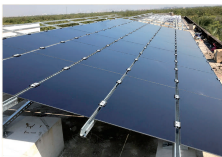
扶貧項目-揭陽南溪中學項目 (裝機容量50.525KW)
